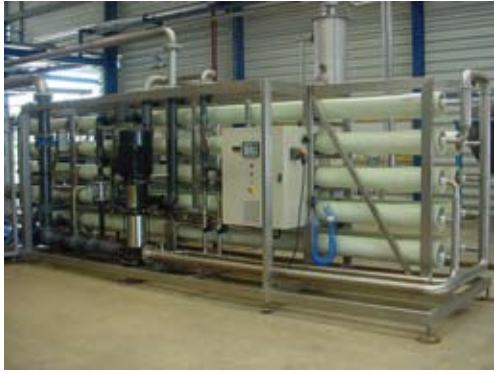
Photo : Osmose inverse 60 m 3 /h
